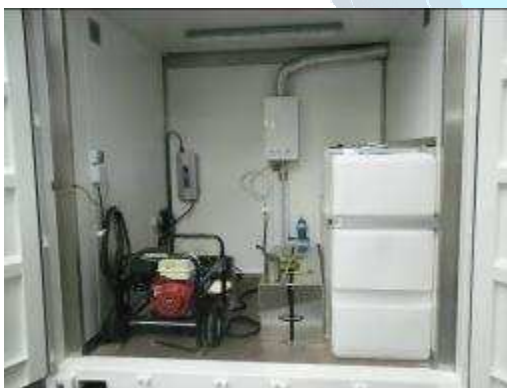
Espace réservé au stockage (groupe électrogène, chaudière, eau...) Storage compartment for generator, water, heating system...)
